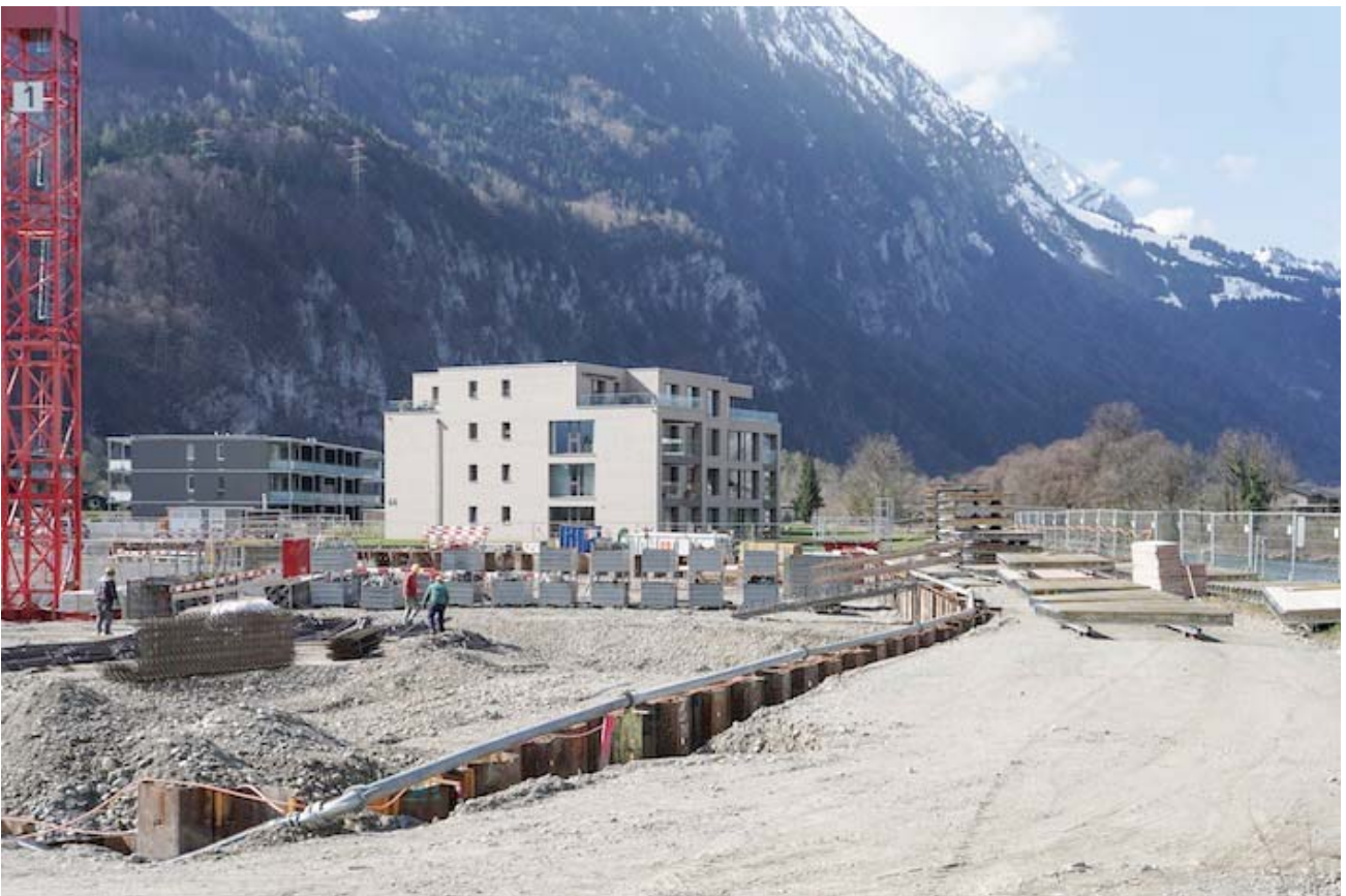
Um die Lift- und Kanalisationsschächte zu schützen, werden Spundwände und eine Wasserhalterung eingesetzt.
